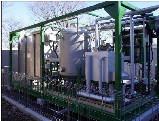
メタン発酵バイオガス発電設備
