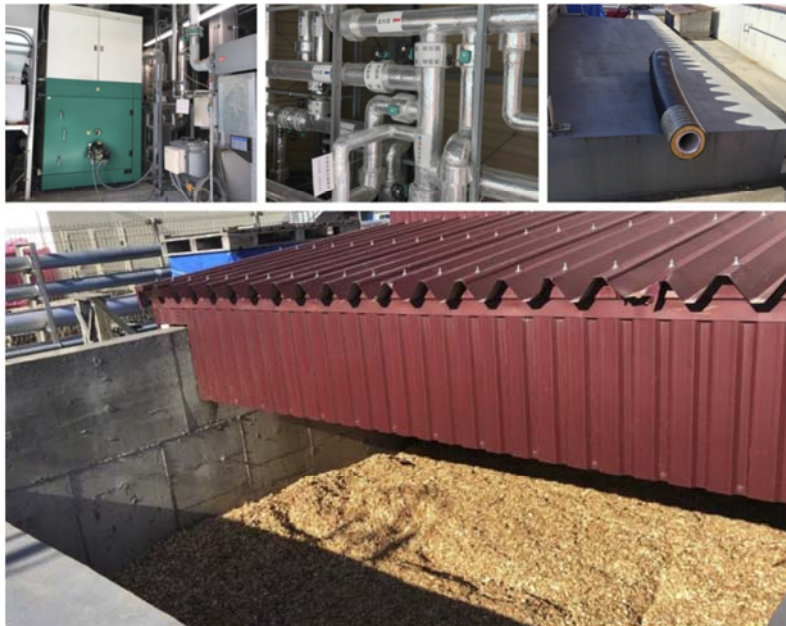
地域冷熱供給を行うエネルギーステーション©オガール
