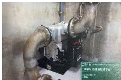
機械設備 (エンジンポンプ)
