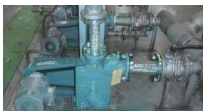
汚泥引抜ポンプ
